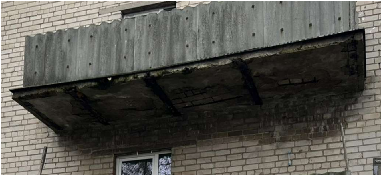
Pav. 8. Trečio aukšto balkono pažaidos.
