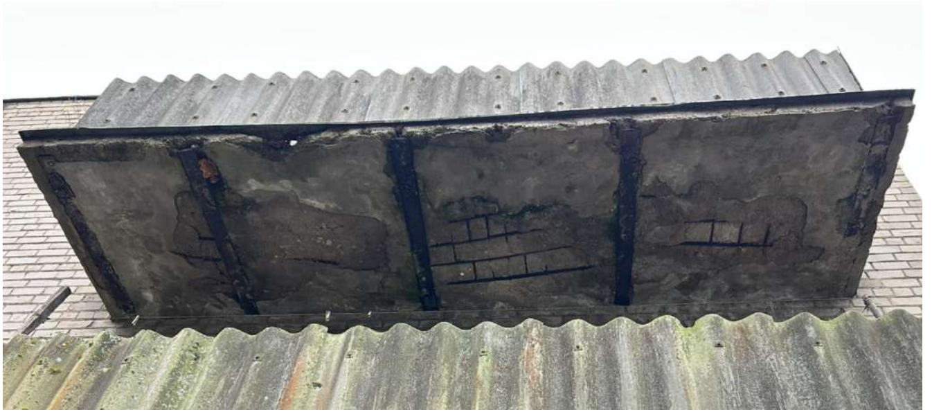
Pav. 9. Trečio aukšto balkono pažaidos.
